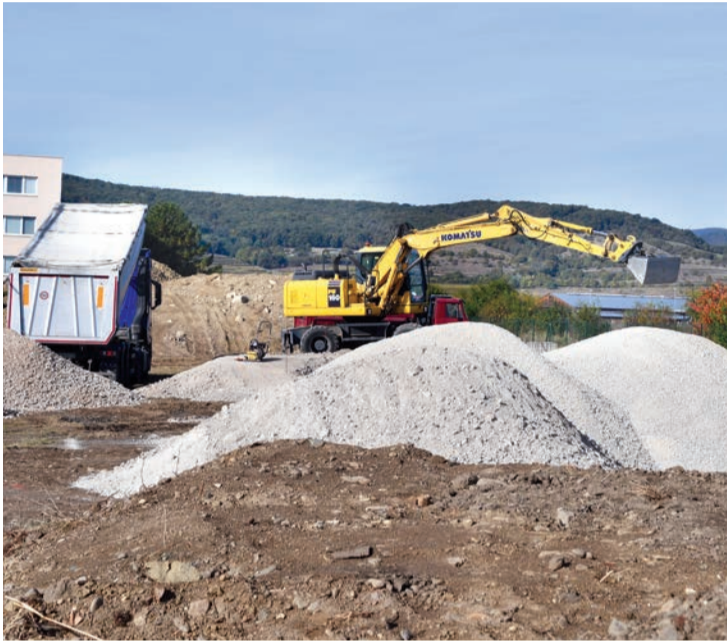
Začala sa výstavba pumptrackovej dráhy. Predpokladaný termín ukončenia prác je koniec decembra
