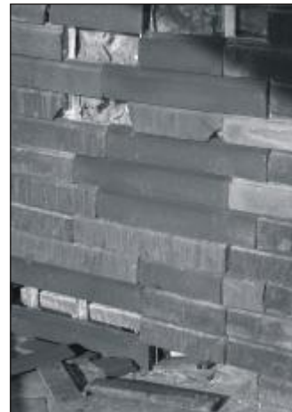
Poškodený obklad na kultúrnom dome.
