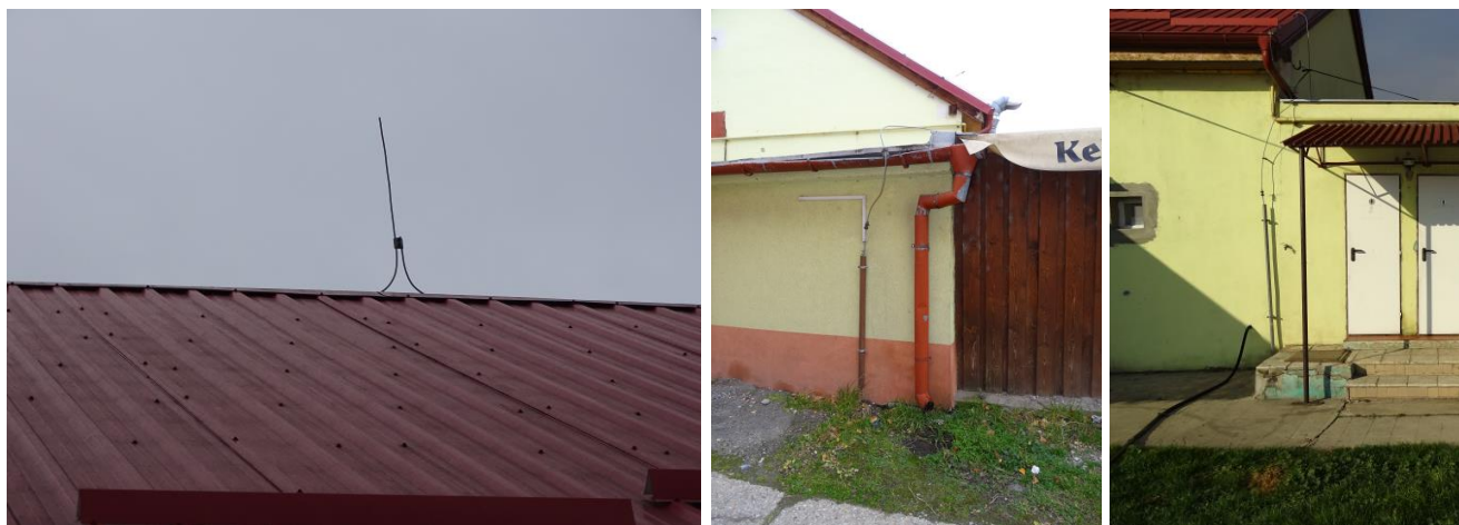
Obr. č. 18 – Bleskozvod
