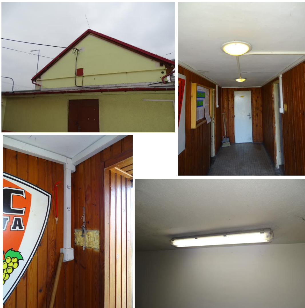
Obr. č. 17 – Vzdušná prípojka elektriny, nové osvetlenie napájané povrchovo v žľaboch, nové rozvody v žľaboch, nové sviedilo.
