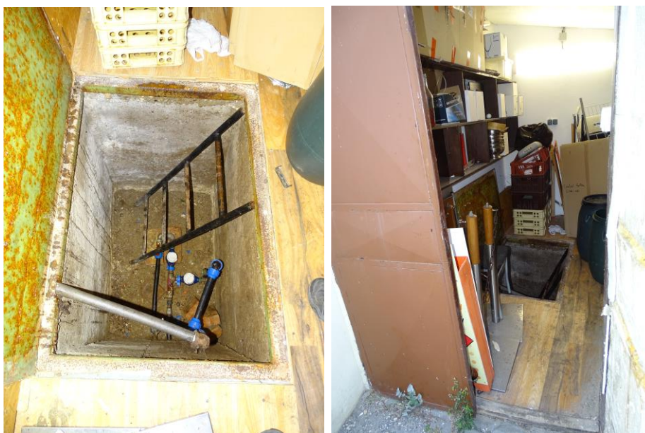
Obr. č. 12 Vodomerná šachta, umiestnenie šachty v sklade.
