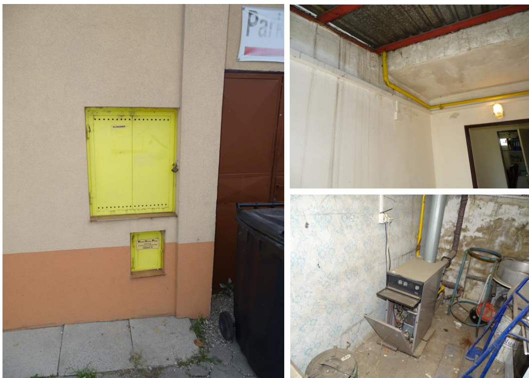
Obr. č. 14 Plynomerné zariadenia – plynomerná skrinky s HUP, rozvod plynu na fasáde pod stropom, plynový kotol na vykurovanie.
