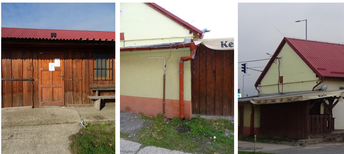
Obr. č. 13 Dažďové vody – prestrešenie terasy bez ríny, dvžďové zvody voľne vyvedené na pozemok
