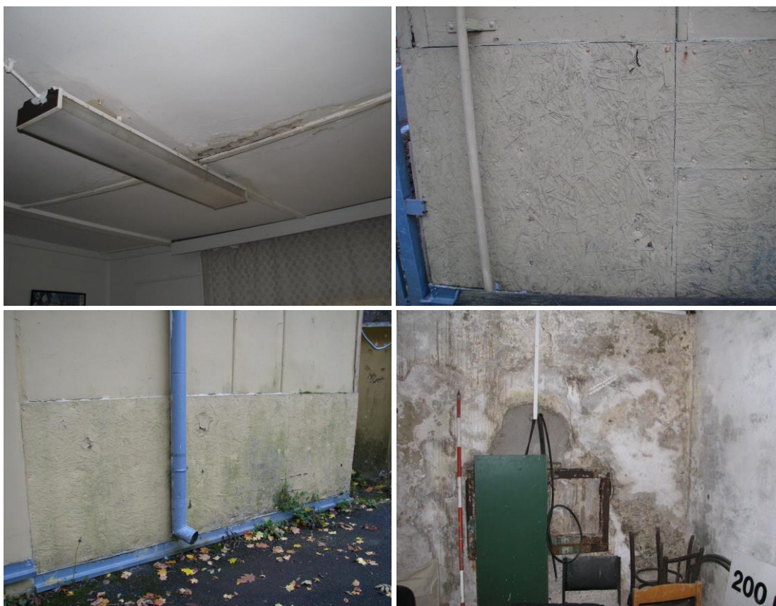
Obr. č. 5 – Úpravy stien interiéru/exteriéru - defekty
