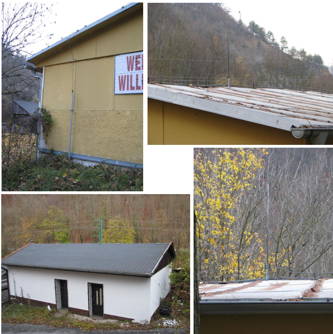
Obr. č. 11 – Bleskozvod vedený zo strechy po fasáde, nástrešné vedenie
