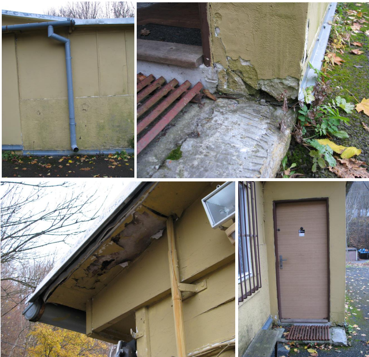
Obr. č. 3 – Pohľady na porušenú fasádu objektu
