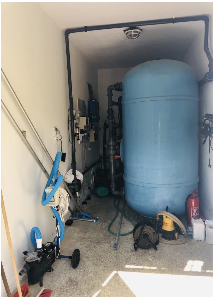
Obr. č. 15 – Časť technológie bazéna - filtre
