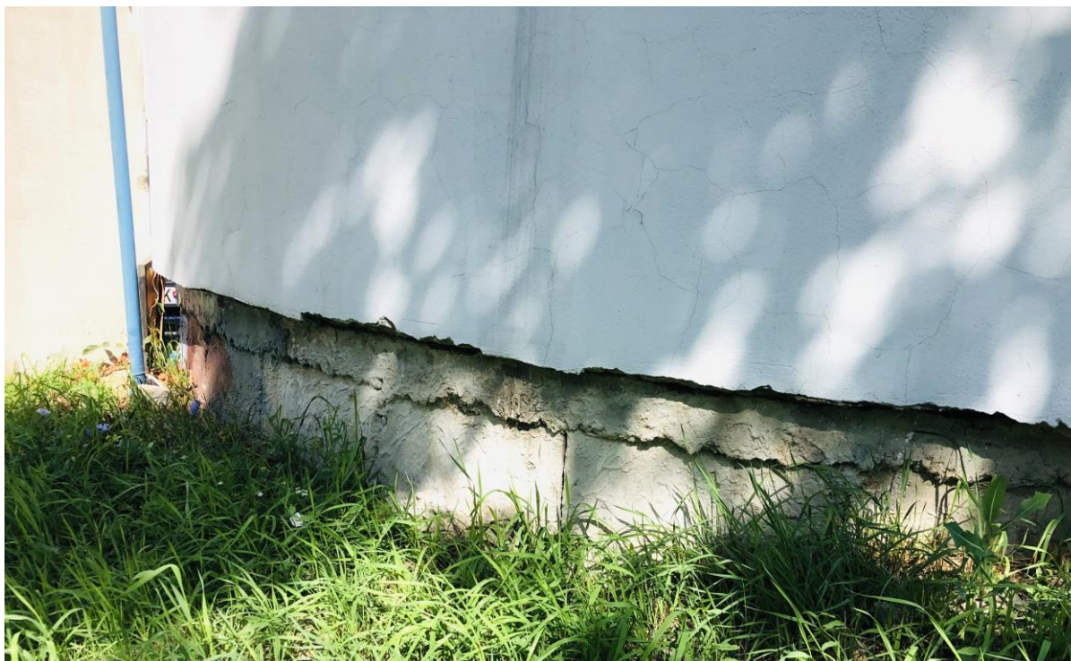
Obr. č. 9 – Popraskaná omietka na fasáde objektu šatní
