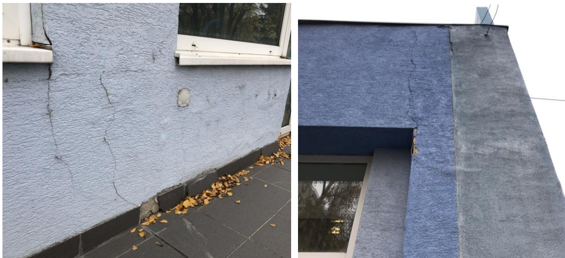
Obr. č. 5 – Trhliny na fasáde objektu
