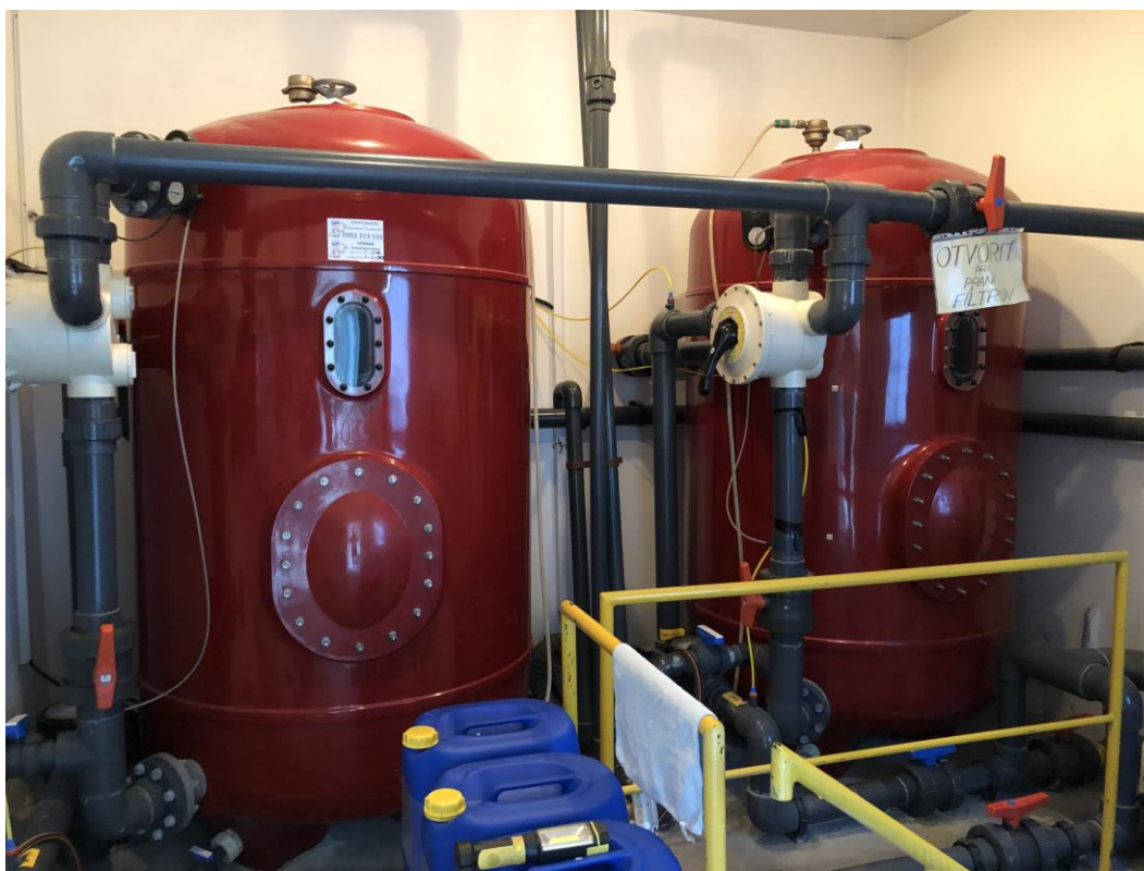
Obr. č. 16 b – Časť technológie bazéna - filtre
