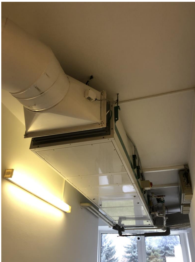
Obr. č. 16 c – Časť technológie vzduchotechniky
