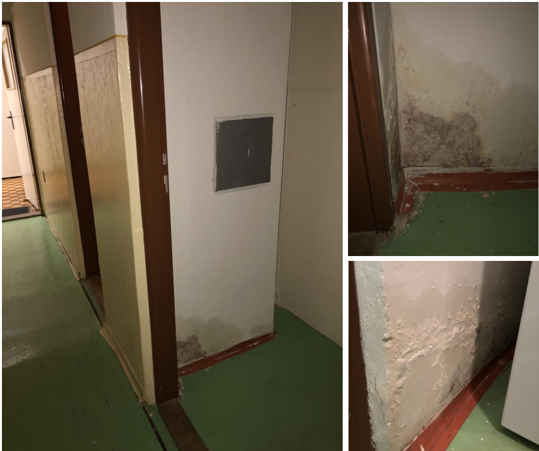
Obr. č. 16 – Poškodené a zvlhnuté steny v technických priestoroch
