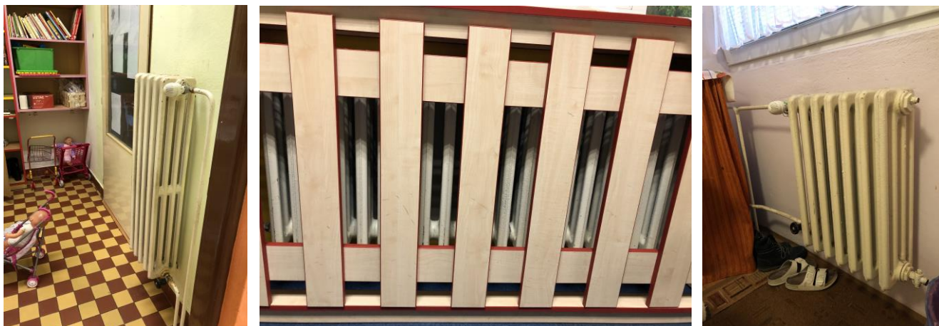
Obr. č. 25 – Vykurovacie telesá v objekte.
