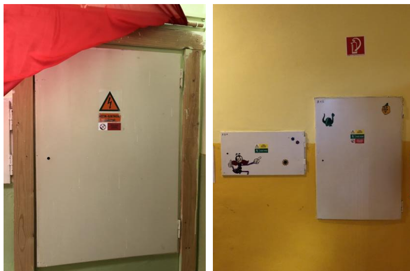
Obr. č. 26 – Elektromer a rozvádzače v objekte
