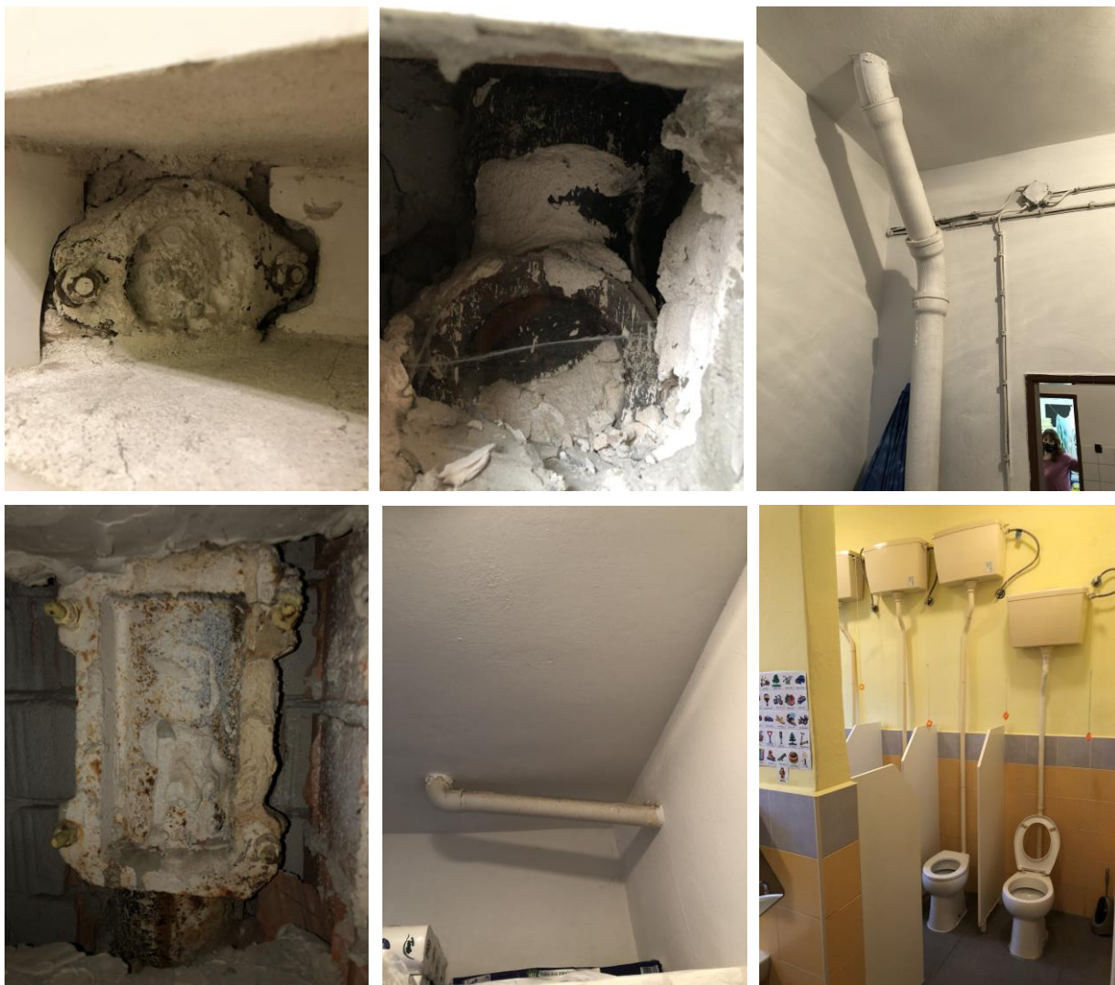
Obr. č. 23 – Vnútorné rozvody splaškovej kanalizácie
