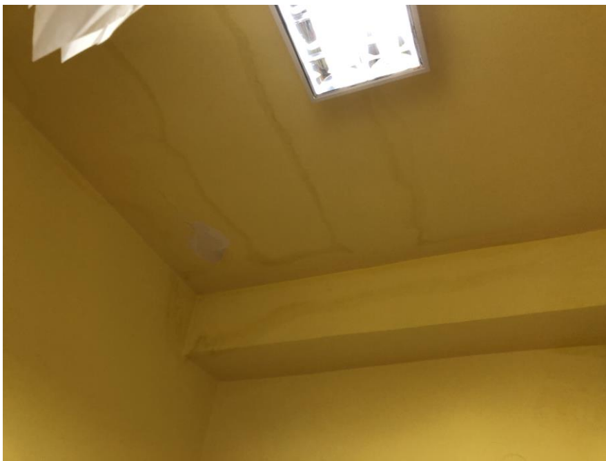
Obr. č. 17 – Zatečený stropy a steny z dôvodu porušenej hydroizolácie strechy
