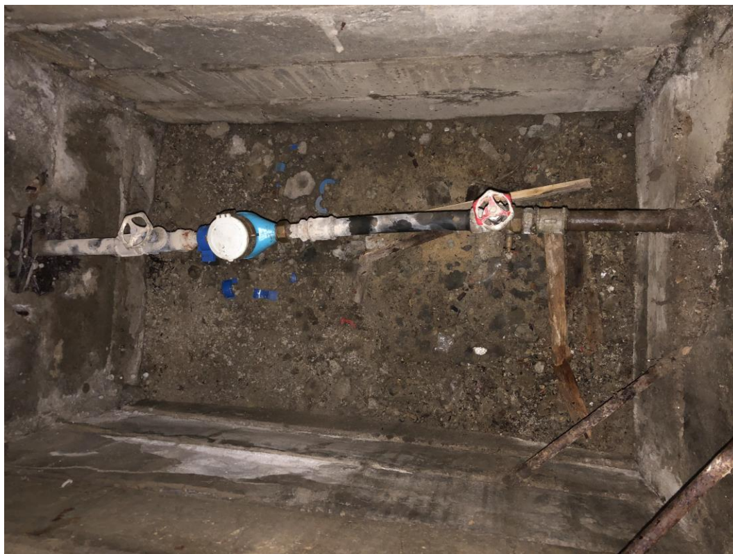
Obr. č. 12 – Hlavný uzáver vody
