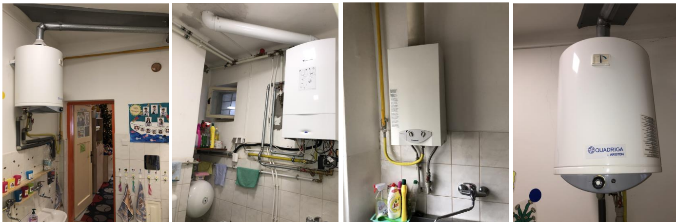
Obr. č. 13 – Plynový kotol pre vykurovanie, plynový zásobník vody v umyvárke/kuchyni
