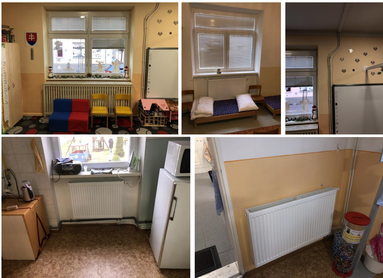
Obr. č. 17 – Vykurovacie telesá, rozvod vykurovania, kotolňa.
