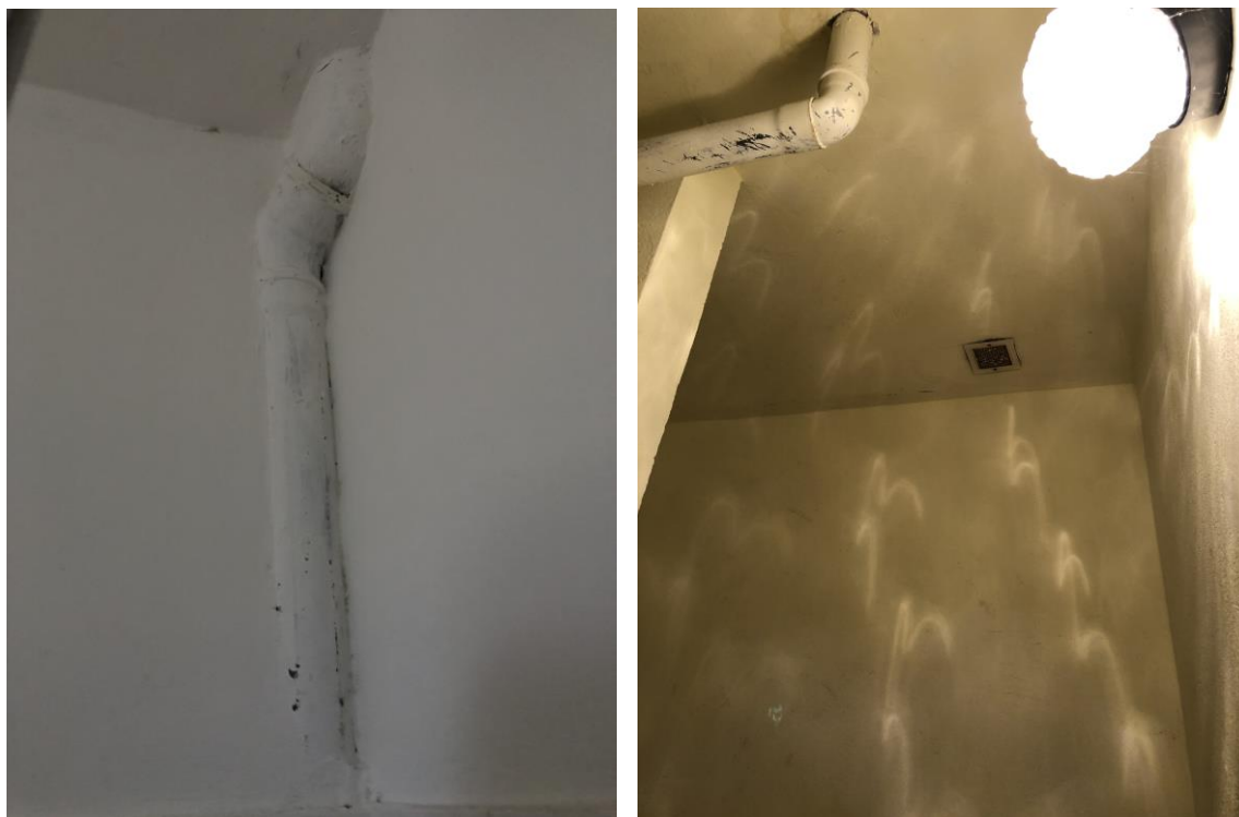
Obr. č. 18 – Vnútorné rozvody splaškovej kanalizácie
