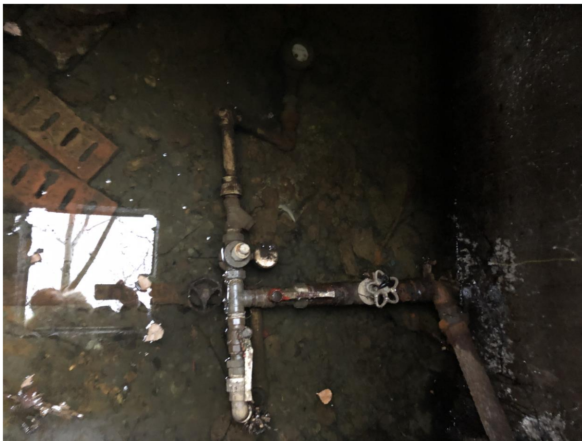
Obr. č.17 – Hlavný uzáver vody
