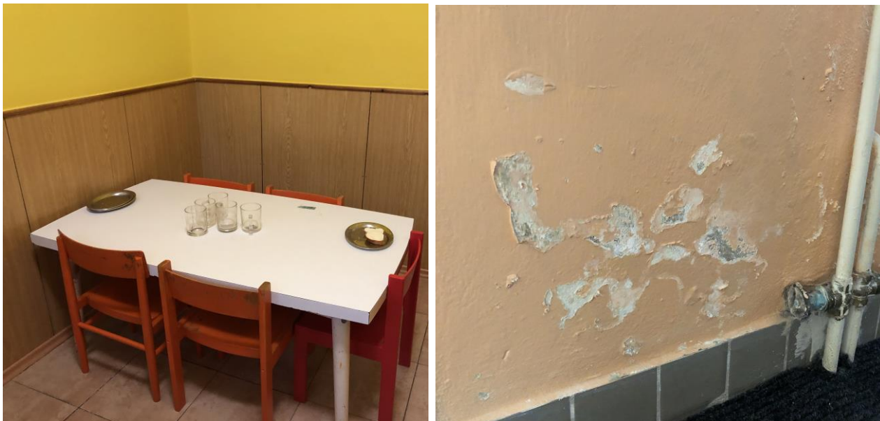
Obr. č. 13 – Pôvodné obklady na stenách a poškodené steny
