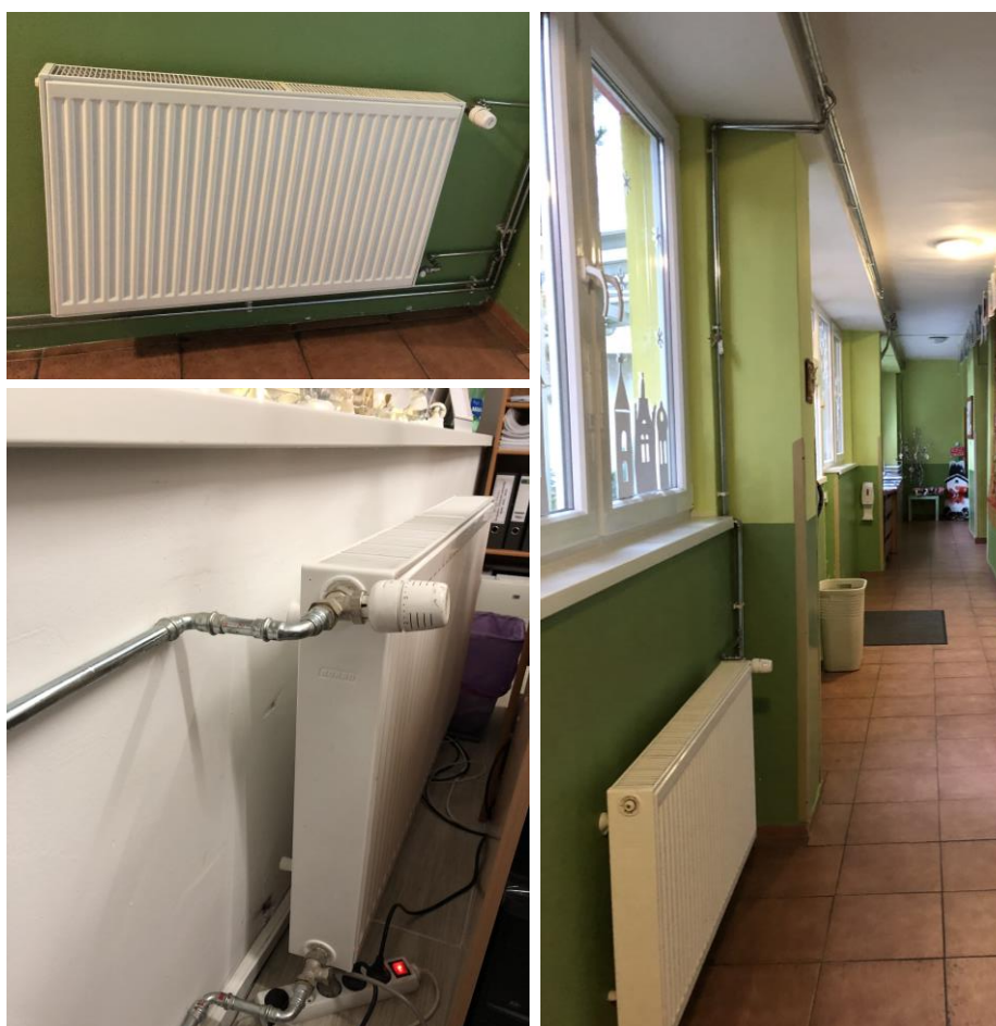
Obr. Č.21 – Vykurovacie telesá, rozvod vykurovania.
