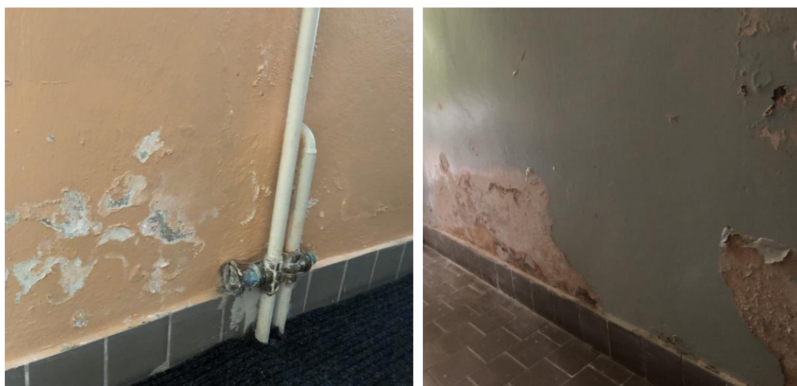
Obr. č. 5 – Zavlhnuté miesta na chodbách.
