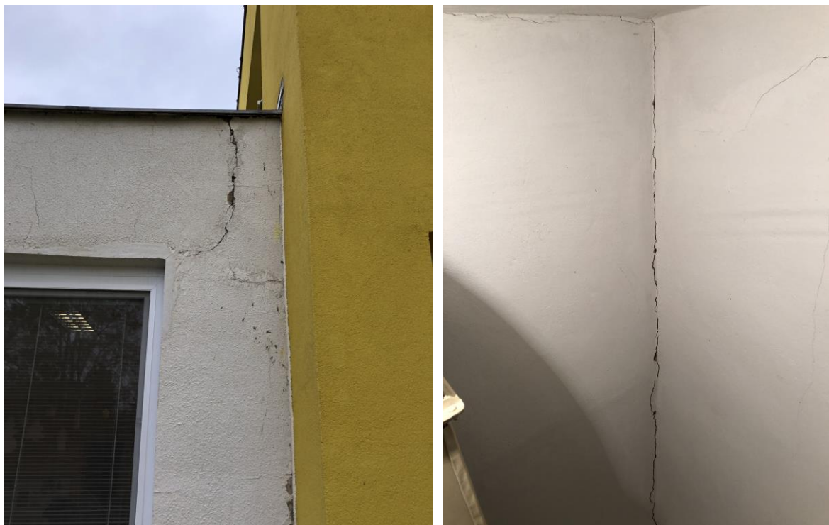
Obr. č. 4 – Trhliny na atike strechy a vo vnútorných skladových priestoroch
