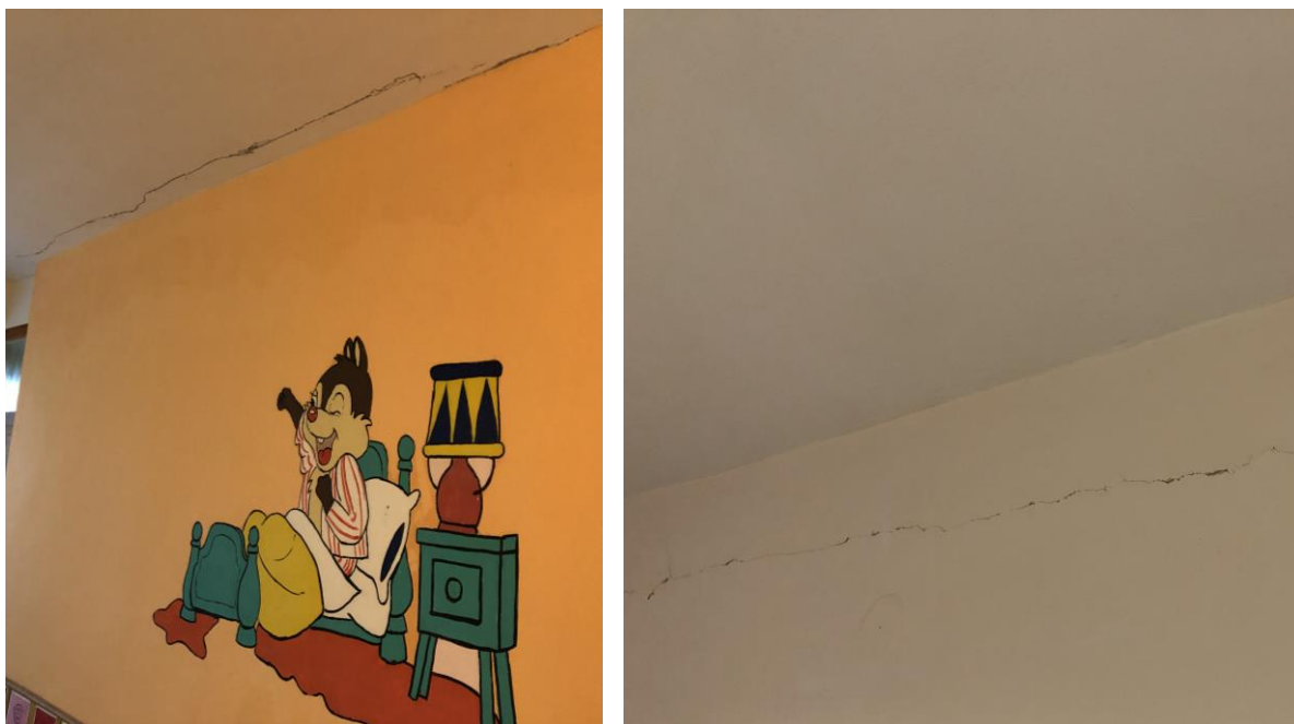
Obr. č. 3 – Trhliny na strope a na stene objektu materskej školy
