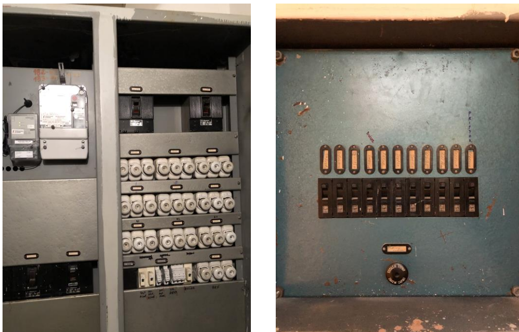
Obr. č.22 – Rozvádzače na prízemí
