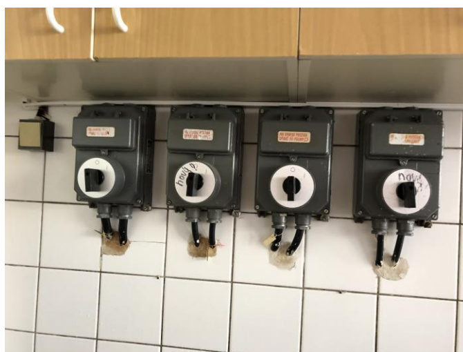
Obr. č. 33 – Pôvodné vypínače
