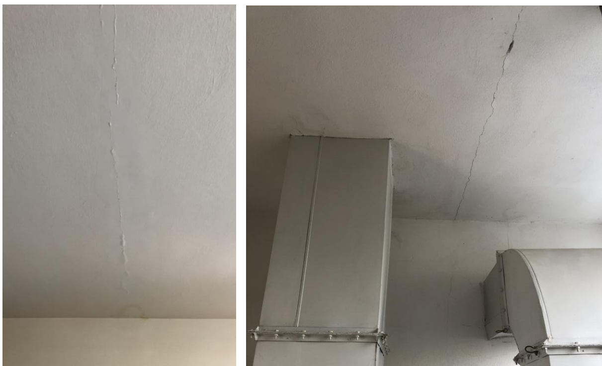
Obr. č. 5 – Priečne trhliny a opadnutá časť omietky na strope
