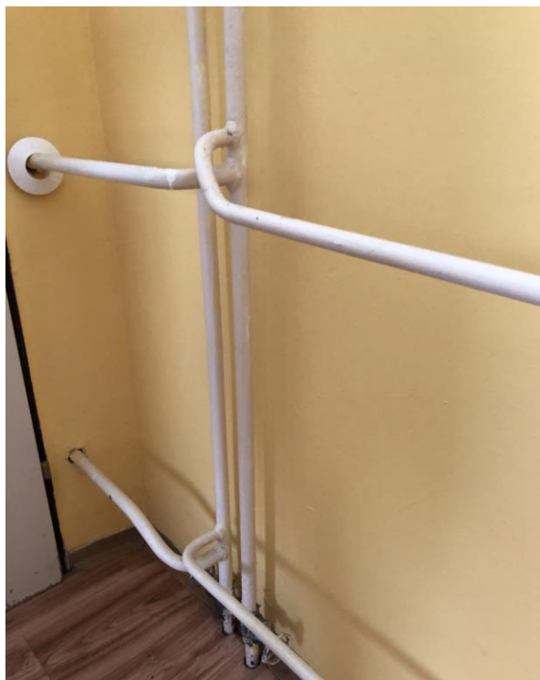
Obr. č. 30 – Vykurovacie rozvody v objete
