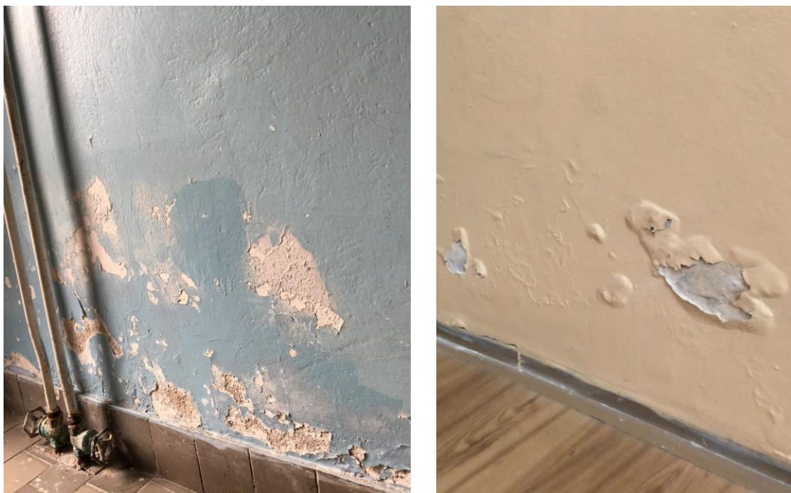
Obr. č. 17 – Poškodené a zvlhnuté steny na chodbách
