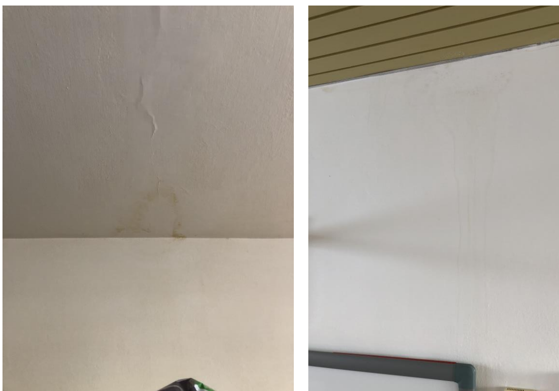
Obr. č. 18 – Zatečený stropy a steny z dôvodu porušenej hydroizolácie strechy
