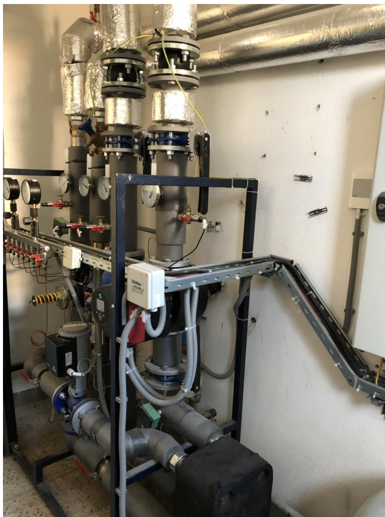
Obr. č. 28 – Technická miestnosť - prívod teplej vody na vykurovanie z výmenníkovej stanice
