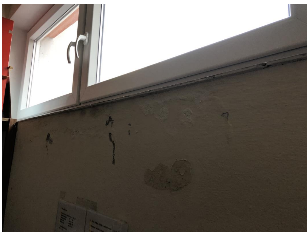
Obr. č. 6 – Zavlhnuté steny pod oknom na prízemí
