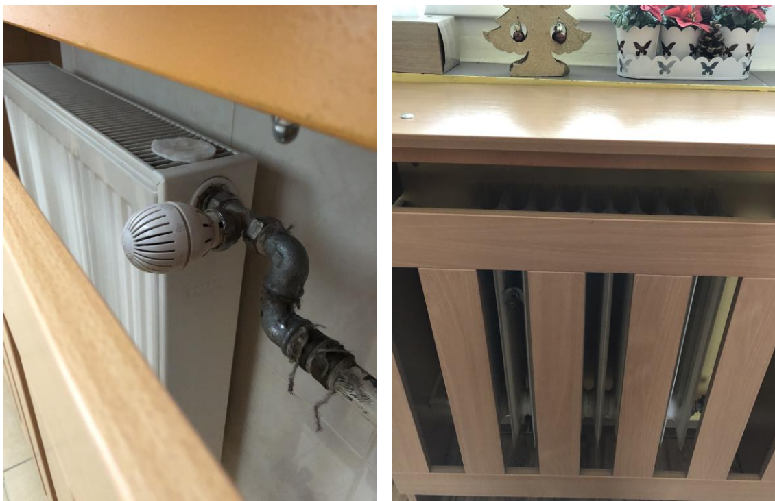
Obr. č.29 – Vykurovacie telesá v objekte.
