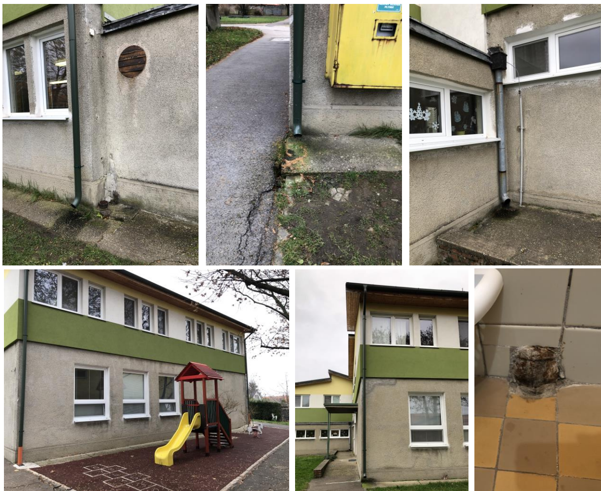
Obr. č. 13 – Dažďové zvody odvedené voľne na terén, vnútorné rozvody splaškovej kanalizácie so zisteným priesakom do muriva
