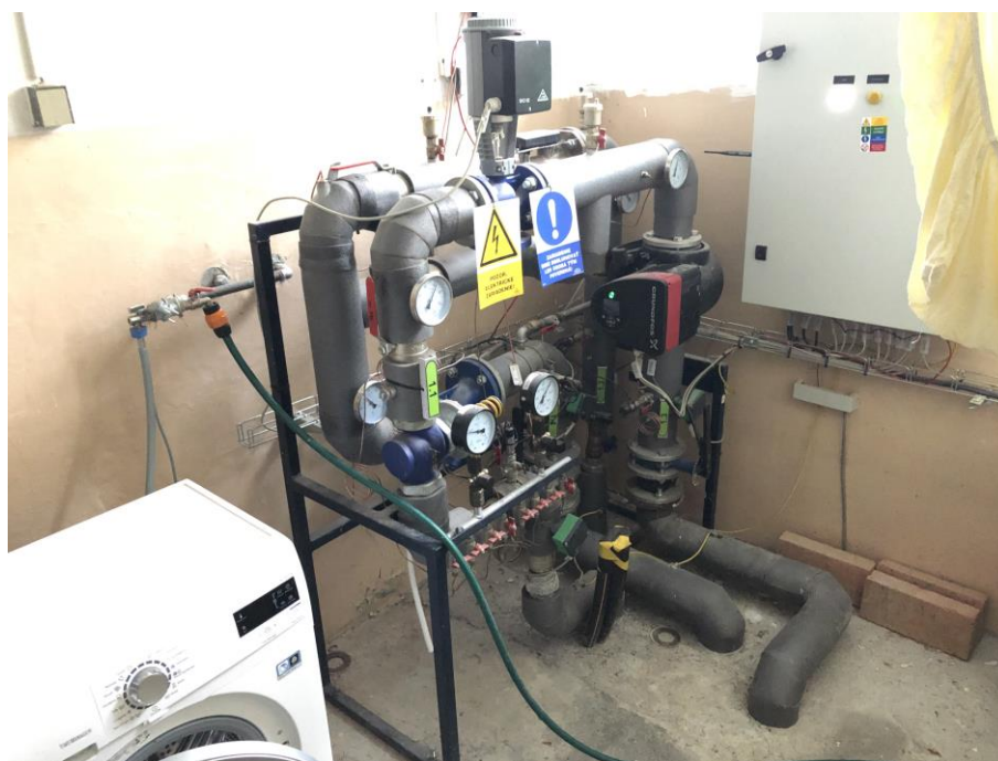
Obr. č. 15 – Technická miestnosť - prívod teplej vody na vykurovanie z výmenníkovej stanice
