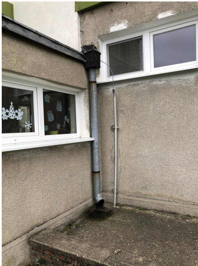
Obr. č. 18 – Bleskozvod
