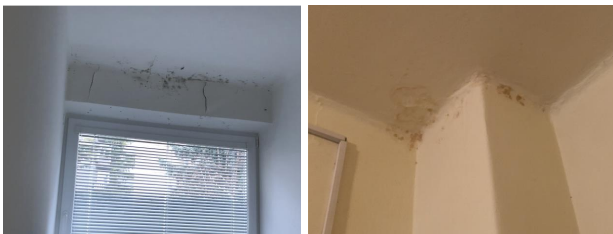
Obr. č. 5 – Plesnivé rohy stien a stropov v technickom zázemí objektu
