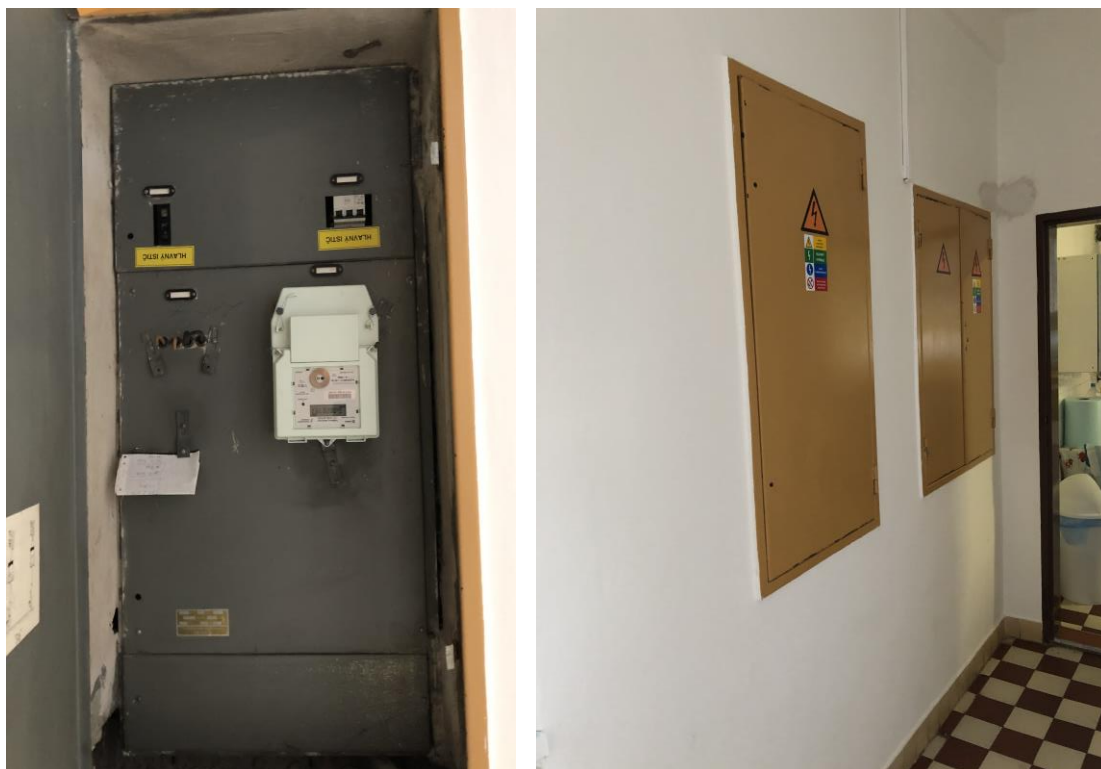
Obr. č.28 – Elektromer a rozvádzače v objekte
