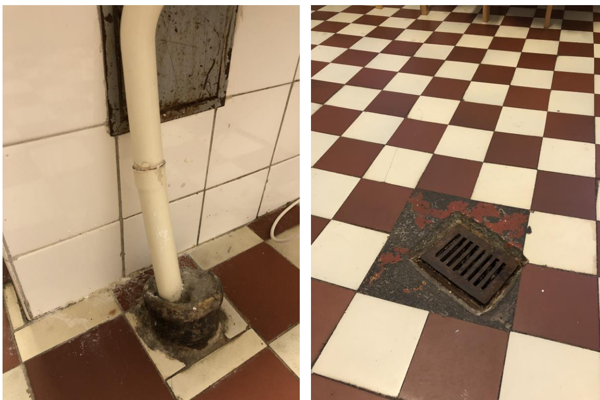
Obr. č. 25 – Vnútorne rozvody splaškovej kanalizácie
