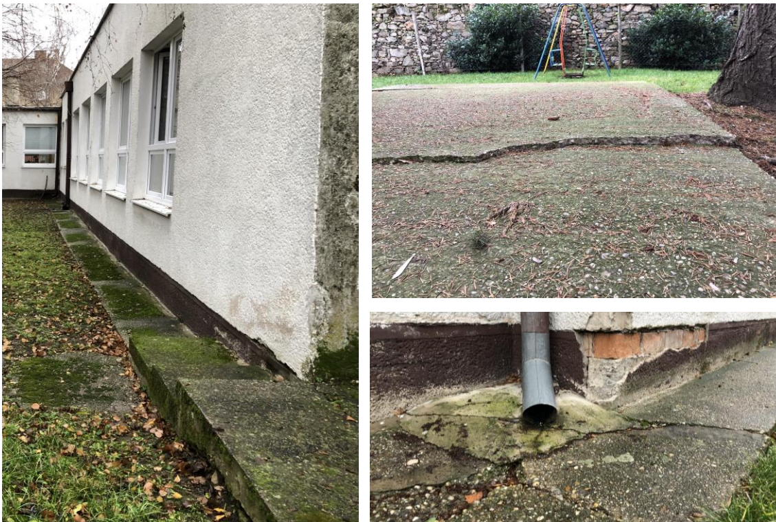
Obr. č.21 – Poškodený okapový chodník a terasa objektu
