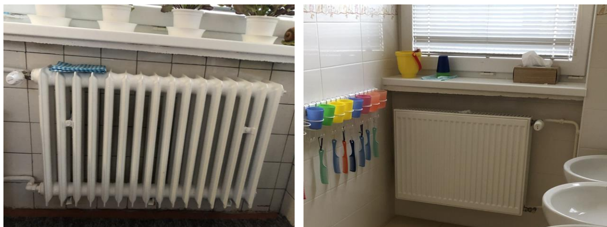
Obr. č.27 – Vykurovacie telesá v objekte.
