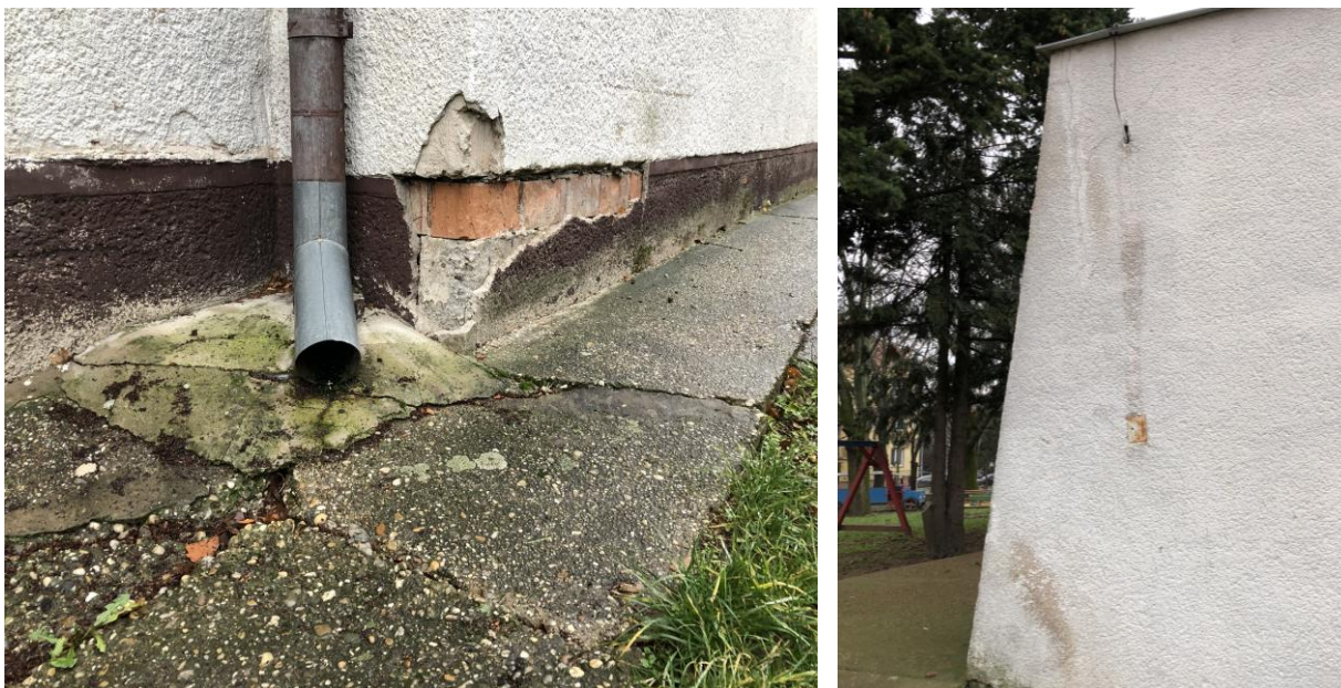
Obr. č. 6 – Opadaná soklová omietka a poškodená časť fasády objektu
