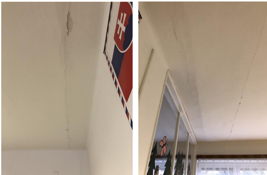
Obr. č. 4 – Priečne trhliny a opadnutá časť omietky na strope v miestnostiach herní
