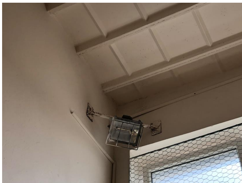
Obr. č. 8 - Vznik plesní v rohoch budovy spôsobených tepelnými mostami, absenciou vzduchotechniky, nedostatočné vykurovanie.
