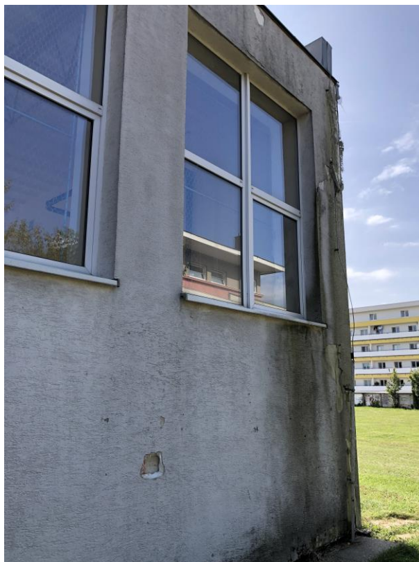
Obr. č. 11 Poškodené zateplenie, fasáda a pravdepodobne aj nosný systém budovy spôsobené zatekaním dažďovej vody
