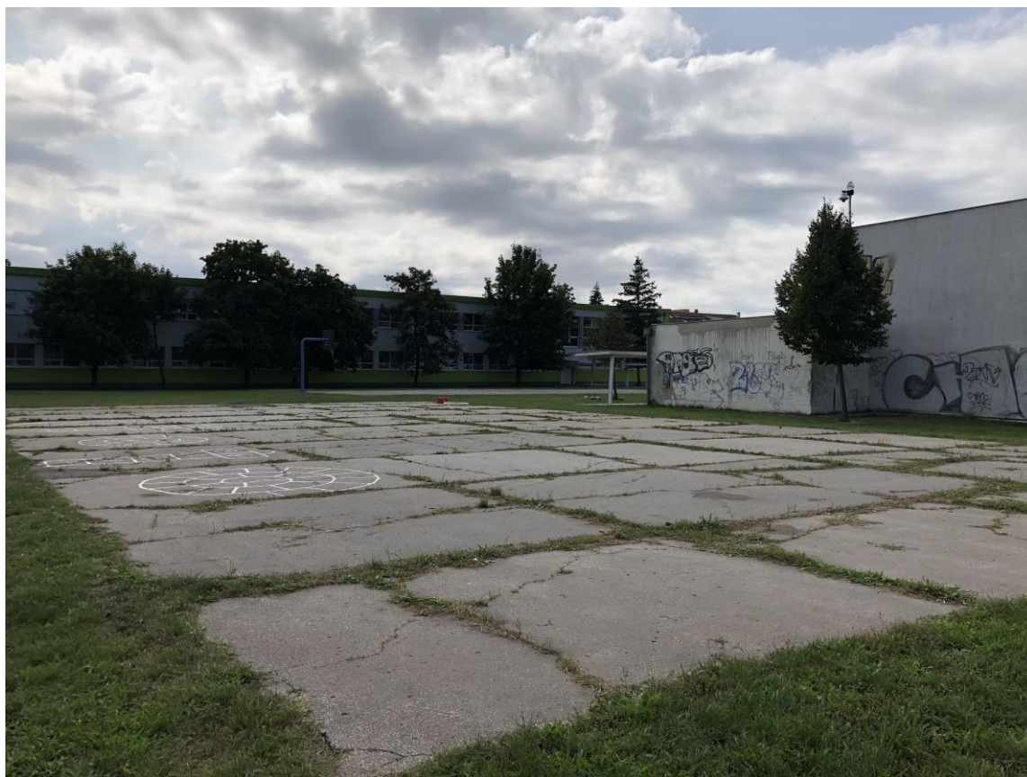
Obr. č. 21 – Poškodený povrch asfaltového ihriska
