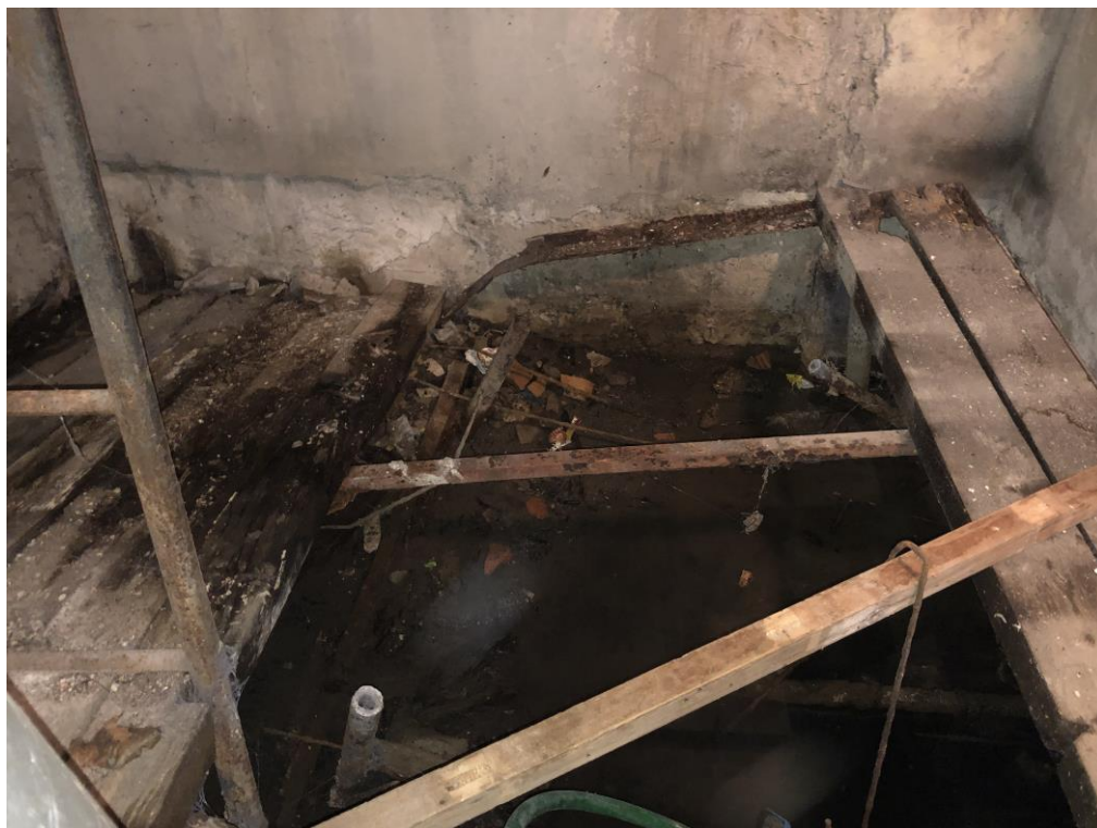
Obr. č. 4 - Zaplavená havarijná nádrž II. PP, degradácia stien od vlhkosti
