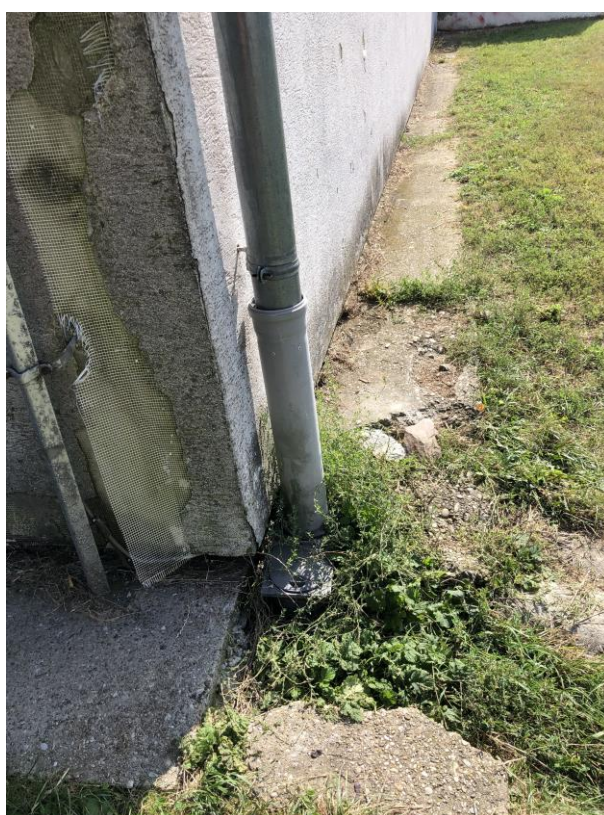
Obr. č. 10 - Poškodený odkvapový chodník okolo objektu telocvične, skontrolovať odtokové pomery dažďových zvodov
