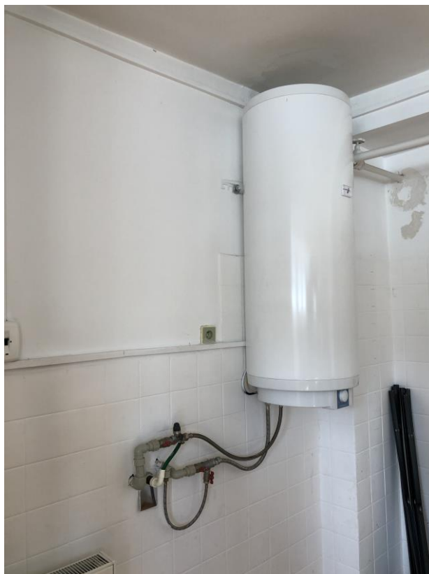
Obr. č. 26 Elektrický zásobník na TUV v objekte telocvične (spolu sú osadené dva zásobníky)
