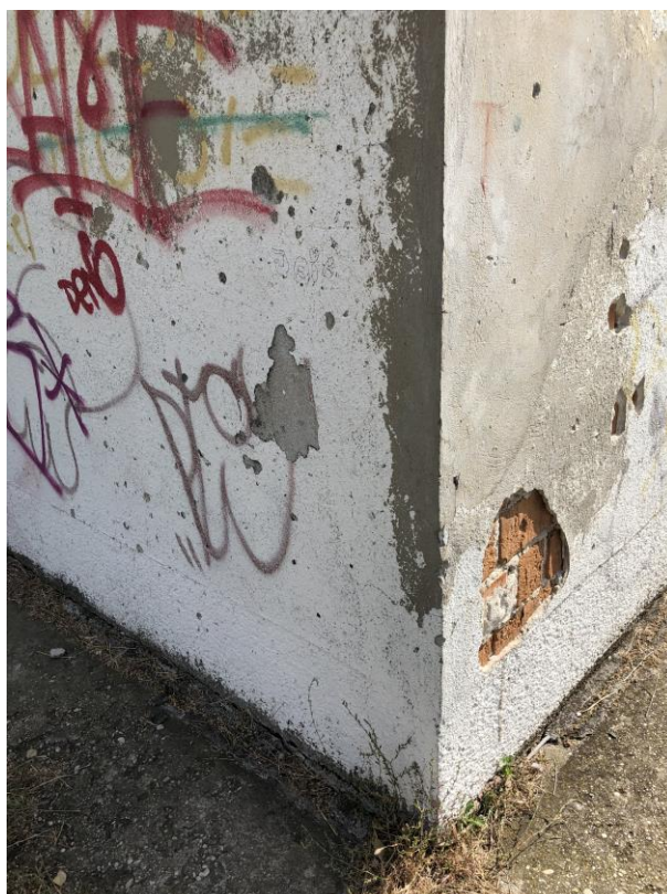
Obr. č. 9 - Poškodenie obvodovej steny šatne spôsobené pravdepodobne navlhnutím muriva
