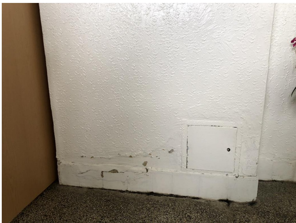
Obr. č. 33 - Revízny otvor stúpačky kanalizácie so známkami rozrušenej omietky muriva spôsobené navlhnutím od pretekania dažďovej vody, pozri tiež detail styku podlahy a steny
