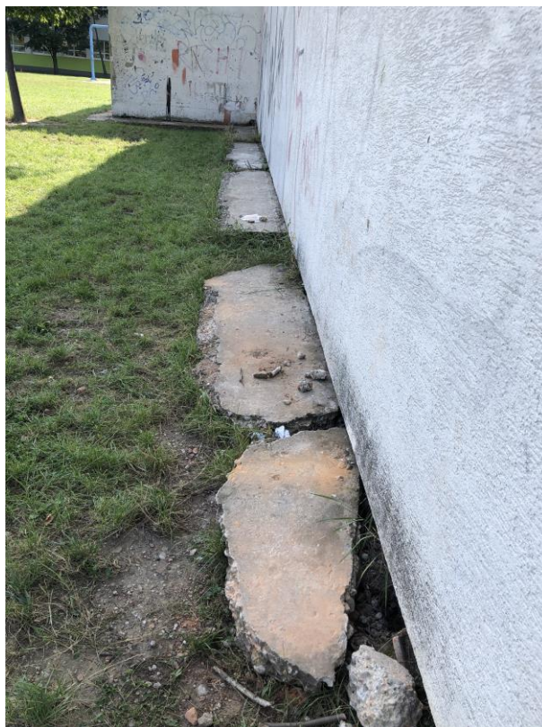
Obr. č. 12 Poškodený odkvapový chodník pri telocvični
