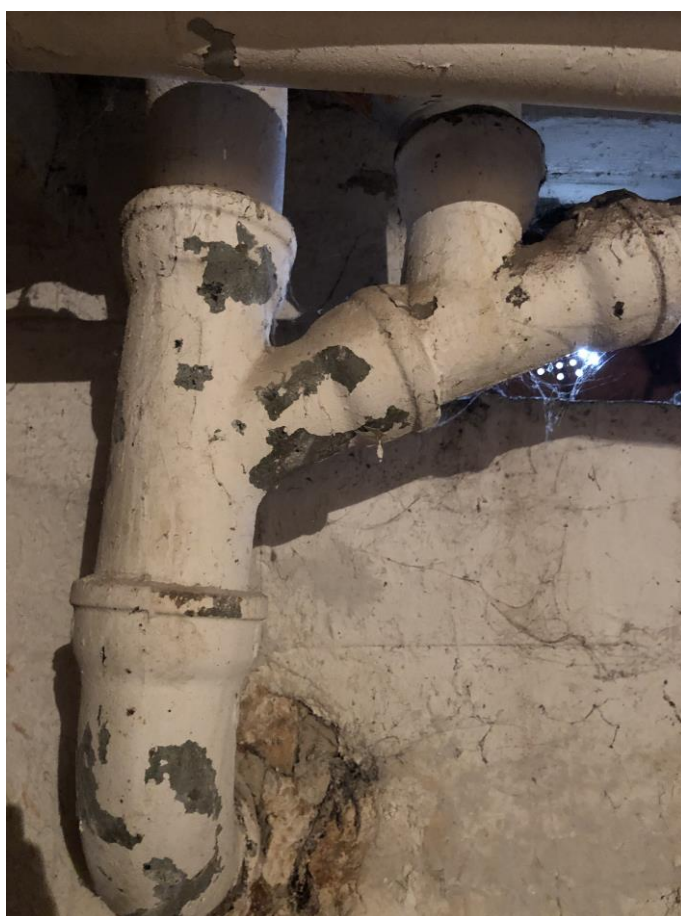
Obr. č. 28 - Degradované liatinové kanalizačné potrubie v suteréne objektu
