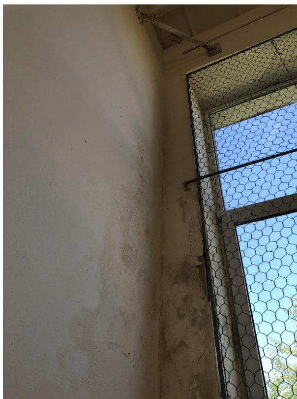
Obr. č. 7 - Degradovaná stena v telocvični spôsobená zatekaním od poškodeného odkvapového systému, vznik plesní a degradácia nosného systému budovy
