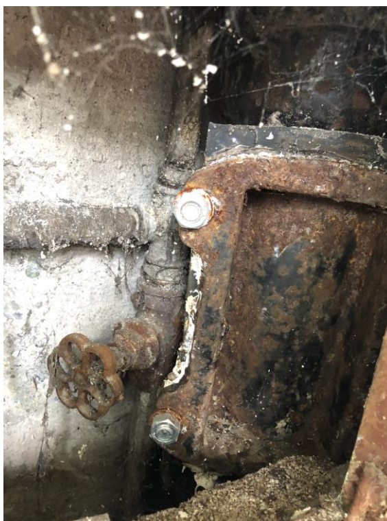
Obr. č. 32 - Oceľové vodovodné potrubie s ventilom a liatinové kanalizačné potrubie (detail z revíznej šachty)
