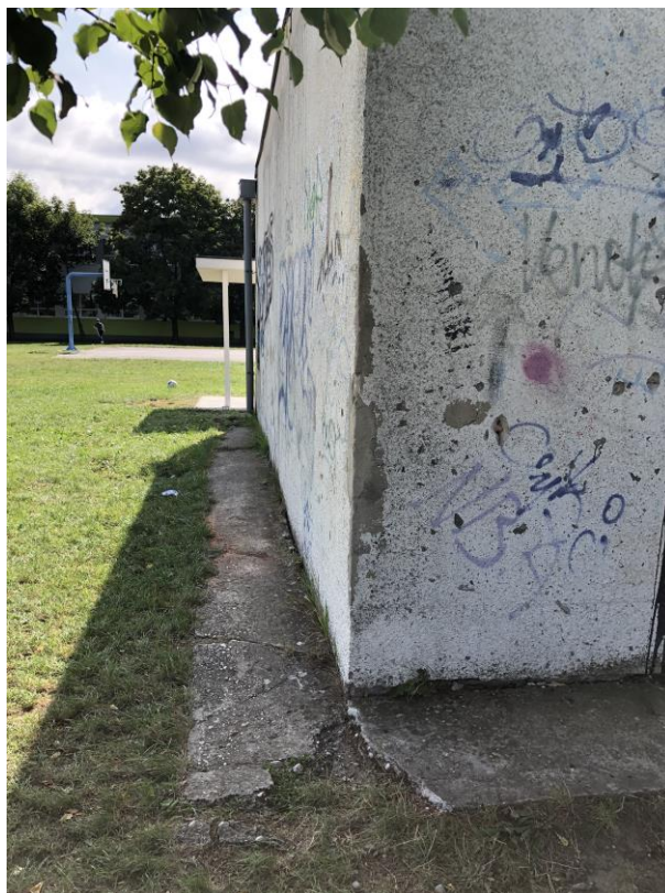
Obr. č. 13 Poškodený odkvapový chodník pri telocvični
