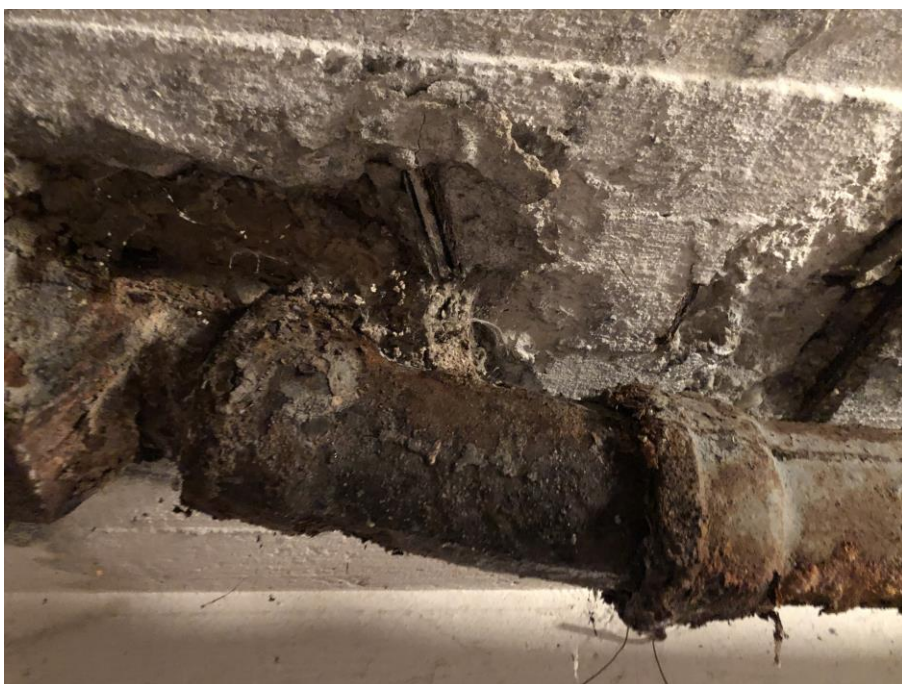
Obr. č. 27 - Degradované liatinové kanalizačné potrubie v suteréne objektu
