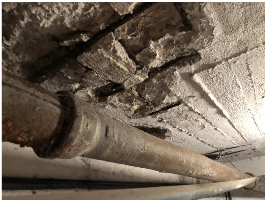
Obr. č. 3 - Odkrytá a skorodovaná betonárska výstuž stropu I. PP
