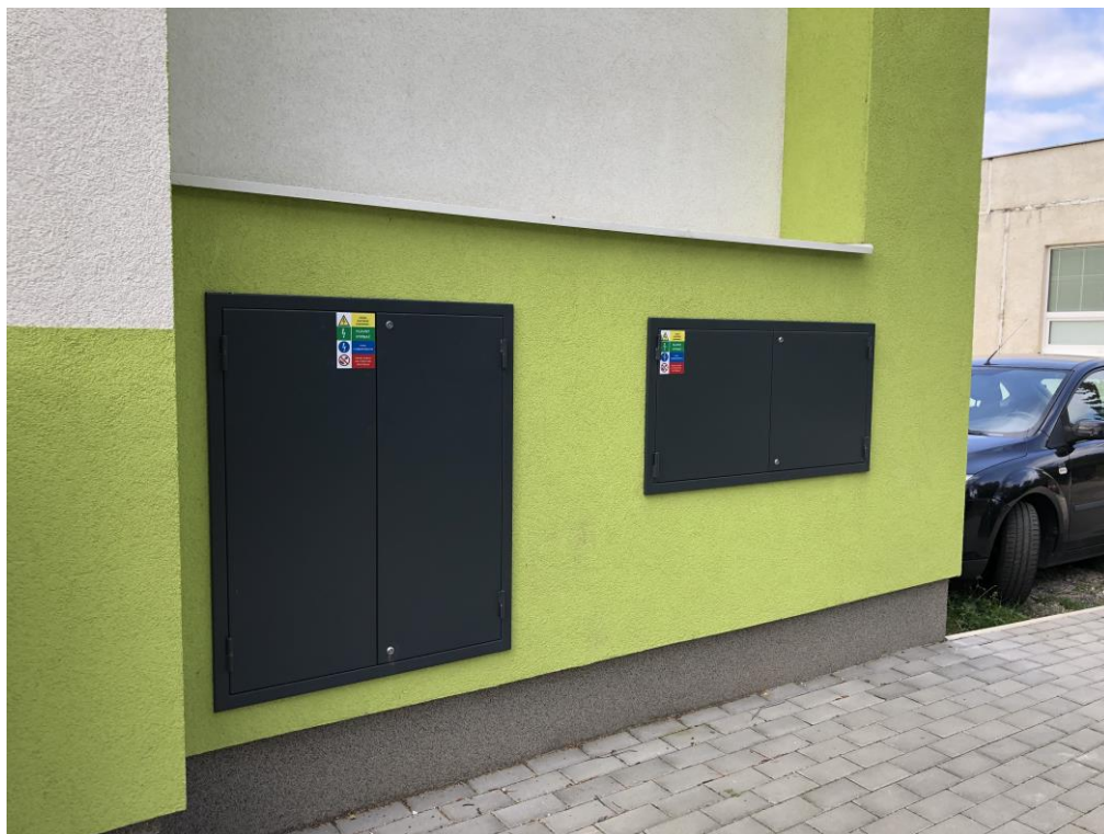
Obr. č.: 40 - Elektrické rozvodné skrine
