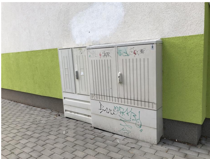
Obr. č.: 41 - Elektrické rozvodné skrine
