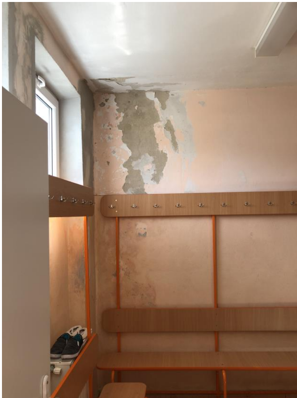
Obr. č. 6 - Degradovaná stena šatne v telocvični
