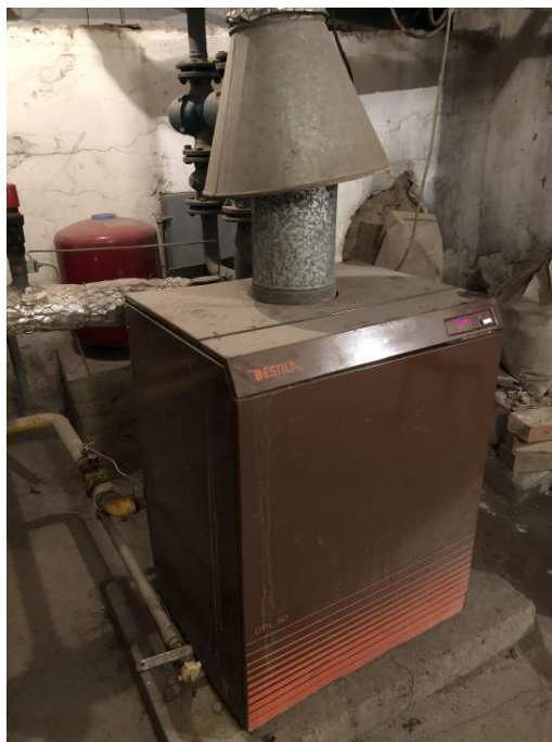
Obr. č. 24 - Plynový kotol DESTILA DOL 45 na prípravu TUV pre kuchyňu (r.v. 1986)
