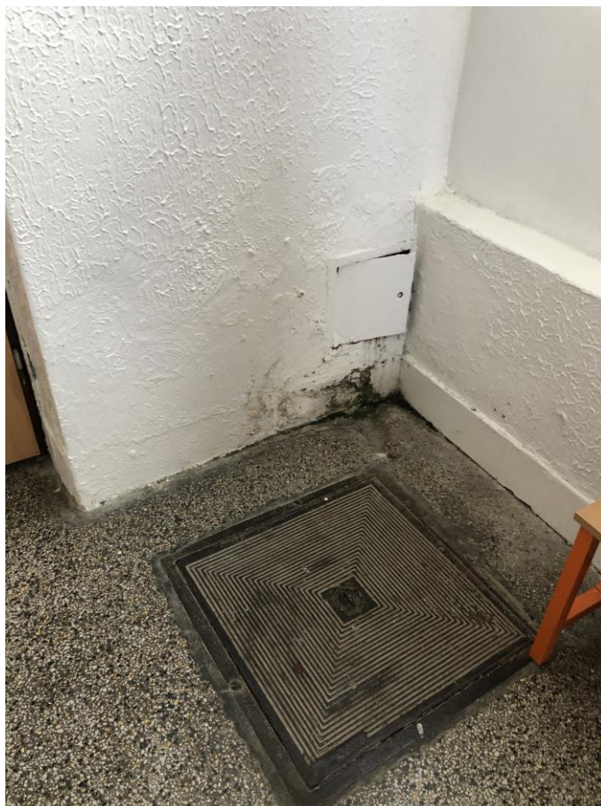
Obr. č. 36 - Revízny otvor stúpačky kanalizácie so známkami rozrušenej omietky muriva spôsobené navlhnutím od pretekania dažďovej vody, pozri tiež detail styku podlahy a steny Degradácia vodorovného a zvislého konštrukčného systému budovy, vznik plesní.
