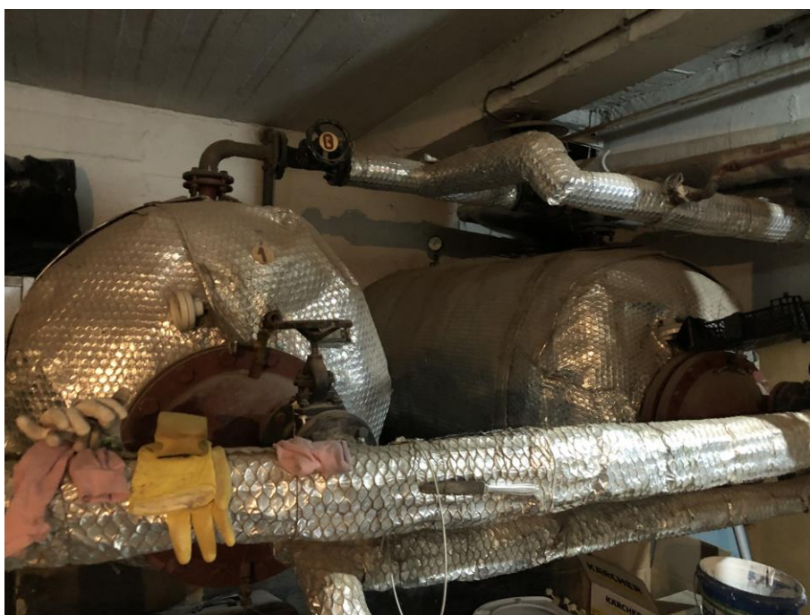
Obr. č. 25 - Zásobníky na TUV pre potreby kuchyne umiestnené v suteréne (pod priestormi kuchyne)
