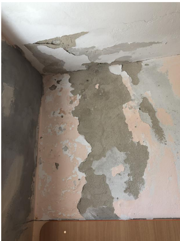
Obr. č. 5 Degradovaná stena šatne v telocvični spôsobená zatekaním od poškodeného odkvapového systému, vznik plesní a degradácia muriva z keramických tvárnic.
