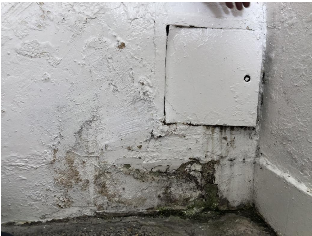
Obr. č. 34 - Revízny otvor stúpačky kanalizácie so známkami rozrušenej omietky muriva spôsobené navlhnutím od pretekania dažďovej vody, pozri tiež detail styku podlahy a steny Degradácia vodorovného a zvislého konštrukčného systému budovy, vznik plesní.
