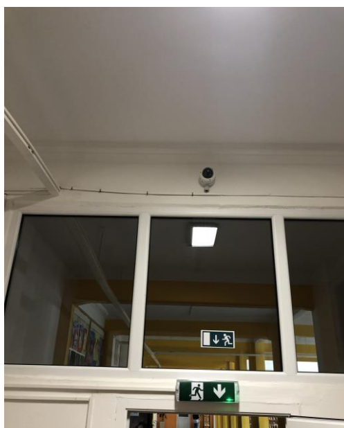
Obr. č.: 42 Kamerový systém, PVC žľab pre slaboprúdové rozvody
