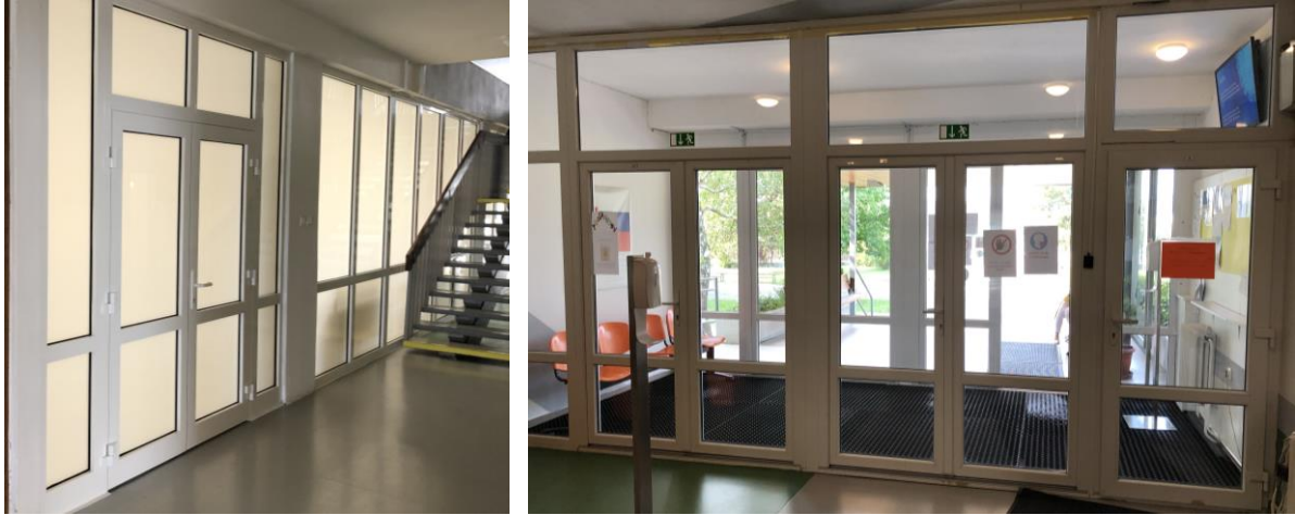
Obr. č. 6 - Vnútročné presklenné steny plastové s izolačným dvojsklom
