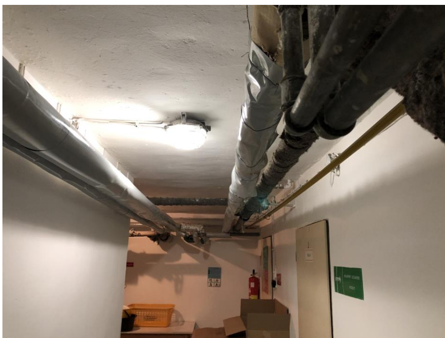
Obr. č.19 – Trasovanie rozvodu plynu v pivničnom priestore
