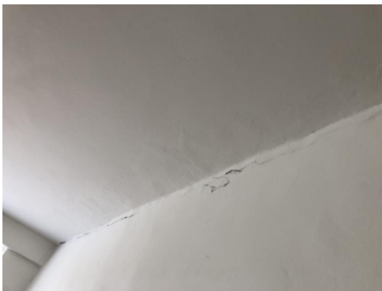
Obr. č. 3 – Trhliny pri styku priečnej a stropnej konštrukcie na 1.N.P. pri vedľajšom vstupe do objektu
