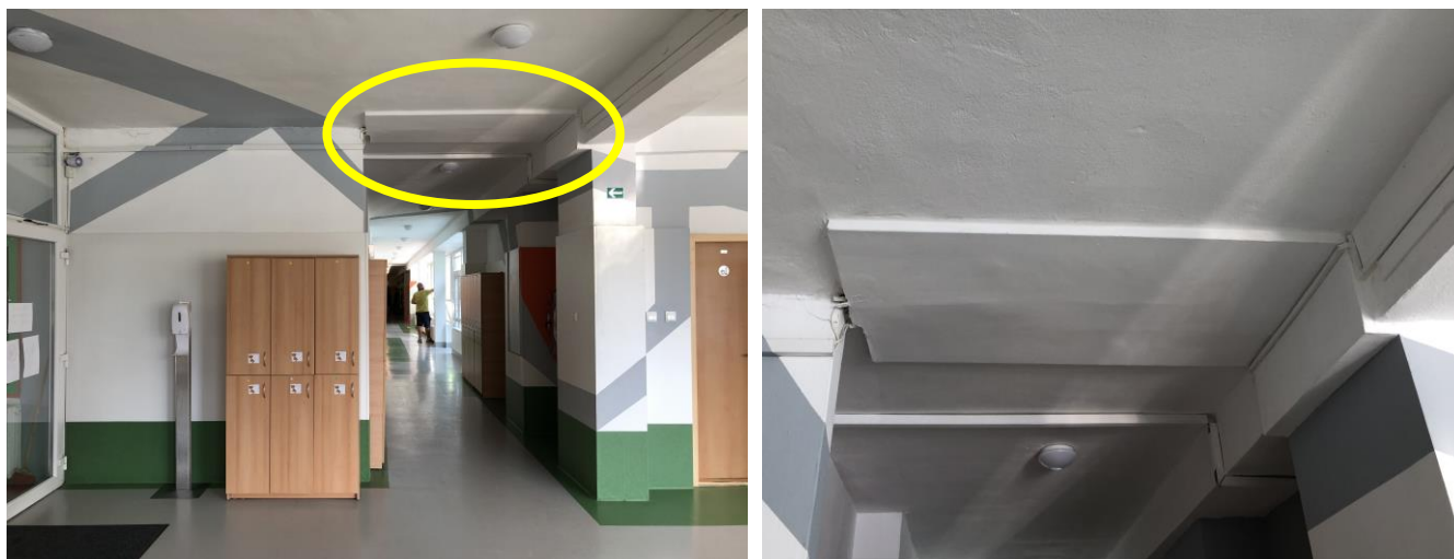
Obr. č. 4 – Prekryté trhliny v škárach na 1.N.P. pri vedľajšom vstupe do objektu
