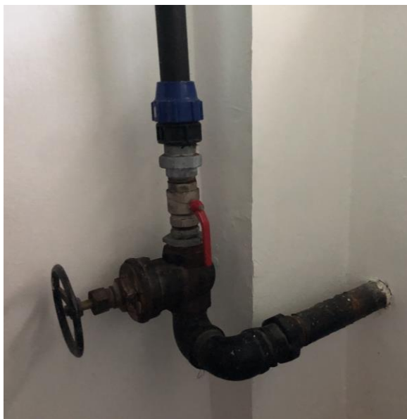
Obr. č.17 – Hlavný uzáver vody v pivničnom priestore
