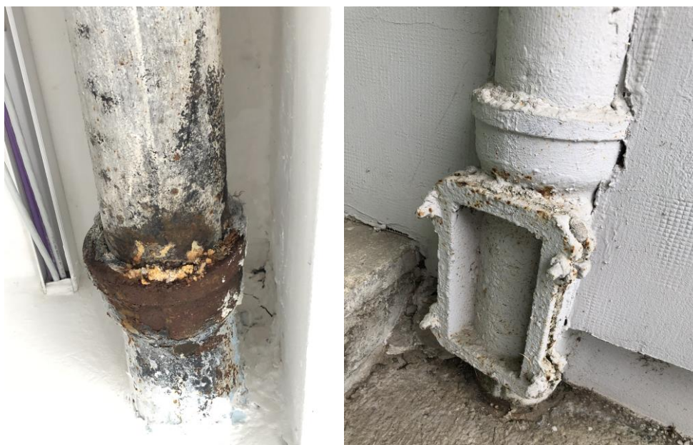
Obr. č.18 – Dažďová kanalizácia v objekt školy
