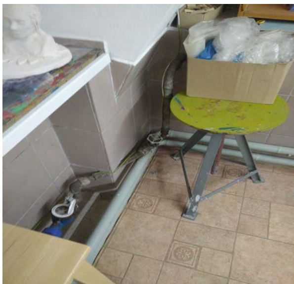
Korózia na povrchu vodovodnej prípojky a slabá ochrana vodomeru.
