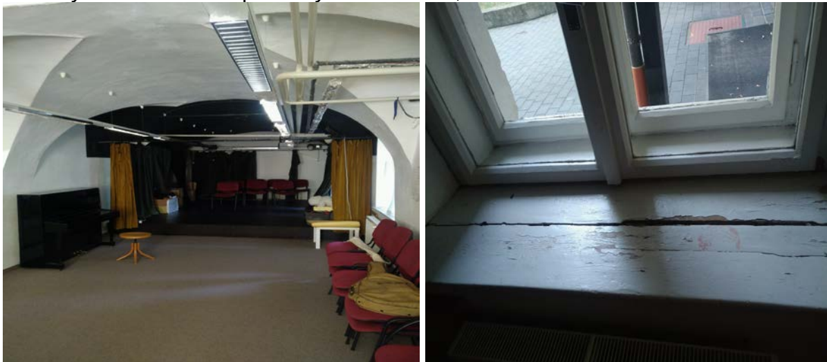
Estetické vady povrchu omietok a degradovaný náter na oknách a ich pôvodných kovaniach
