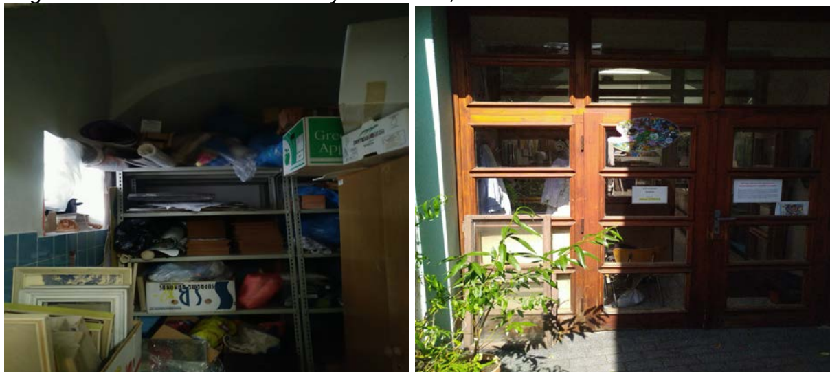
Estetické vady povrchu omietok a degradovaný náter na drevených dverách
